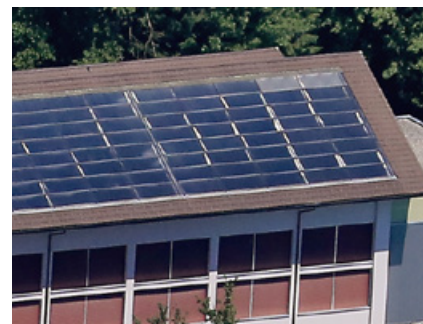
Solaranlage Emmenschachen von oben
